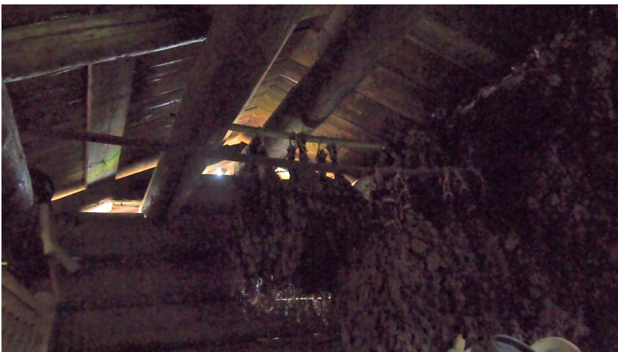
Räynyn aitan ullakkorakenne kurkihirsi hirteen salvotut kurkihirren suuntaiset kannattajat, joiden varassa kattopalkit (vasat). Vasoihin poikittain on kiinnitetty leveät laudat, joihin on kiinnitetty kattolaudat.
